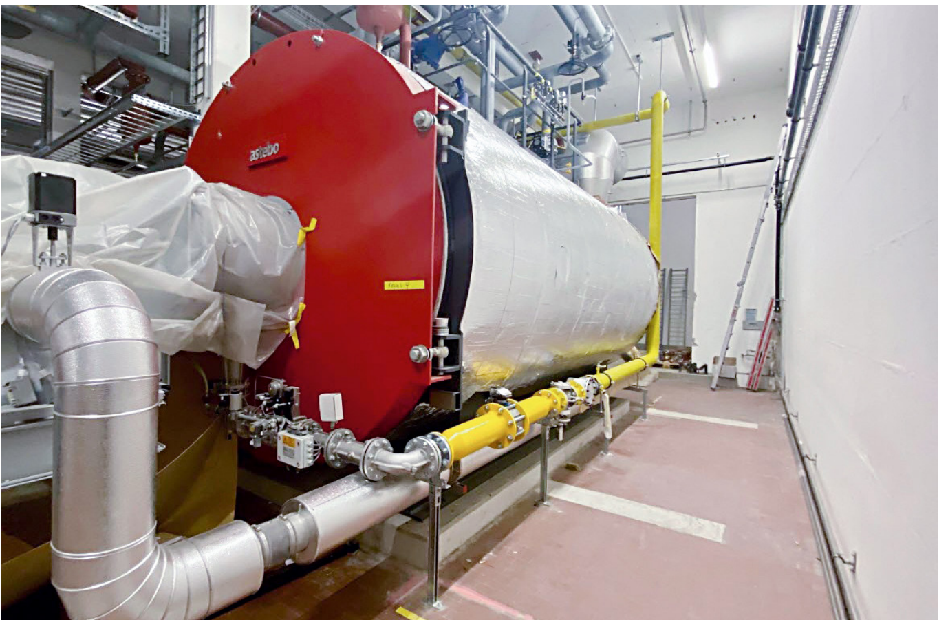
Gasbrenner mit Gasstrasse
